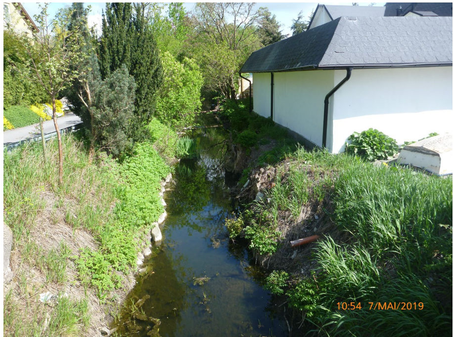
Erosion vid bebyggelse i Flädie, Lomma
