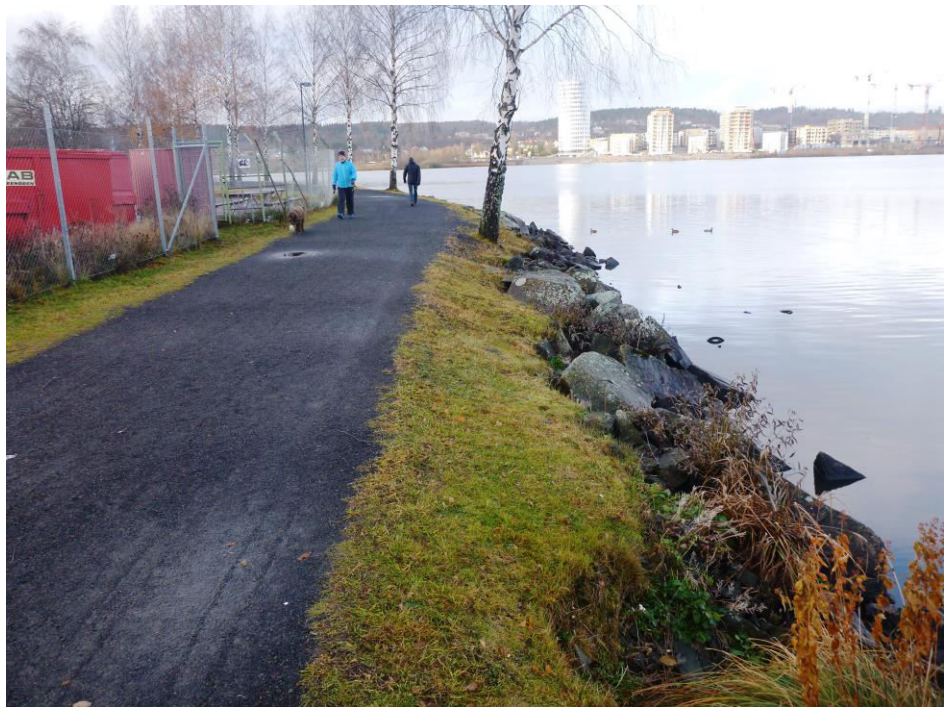
Erosion vid bebyggelse längs sydöstra hörnet av Munksjön, Jönköping
