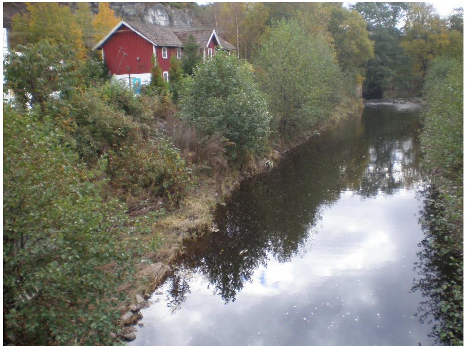
Vy över erosion utmed Vättlandaån genom Skee, Strömstad kommun
