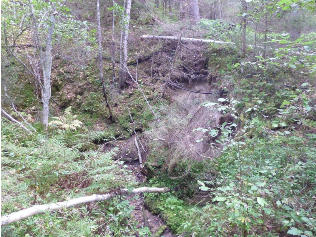
Asplövberget - karteringspunkt 3. Mindre ras i ravinens södra sidoslänt.
