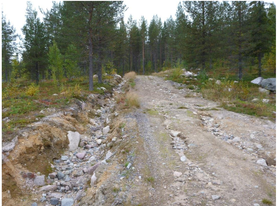
Erosion utmed mindre väg i moränsluttning vid Prästberget, Arvidsjaurs kommun.
