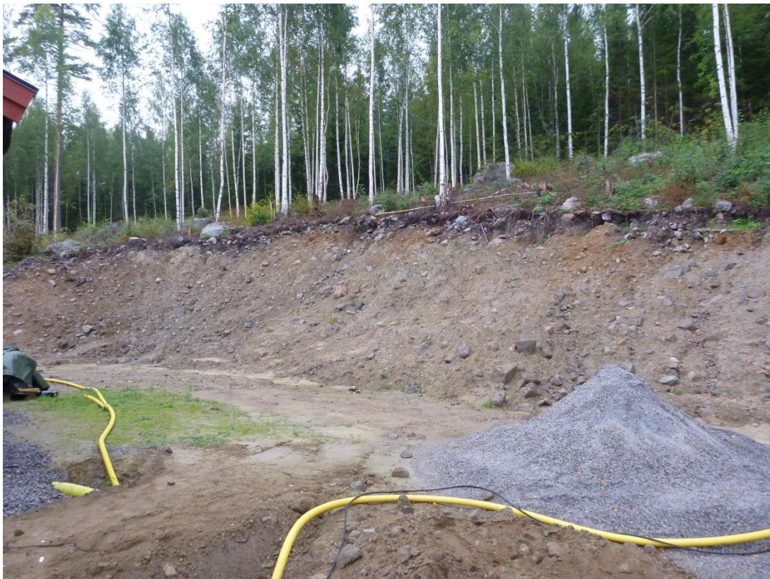
Vedberget - karteringspunkt 2. Fritidshus i moränsluttning, erosion i nyschaktade slänter.
