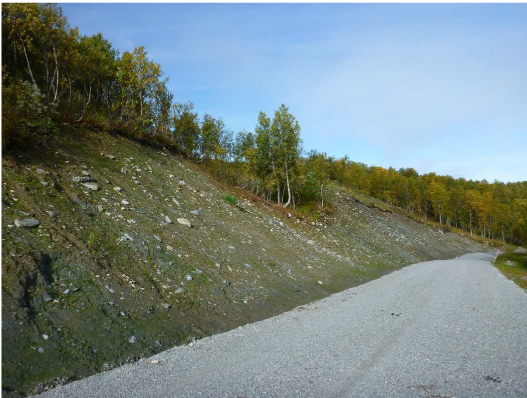
Hamra - karteringspunkt 6. Kraftig erosion i schaktade slänter, en av de schaktade slänterna är som brantast 35 grader.
