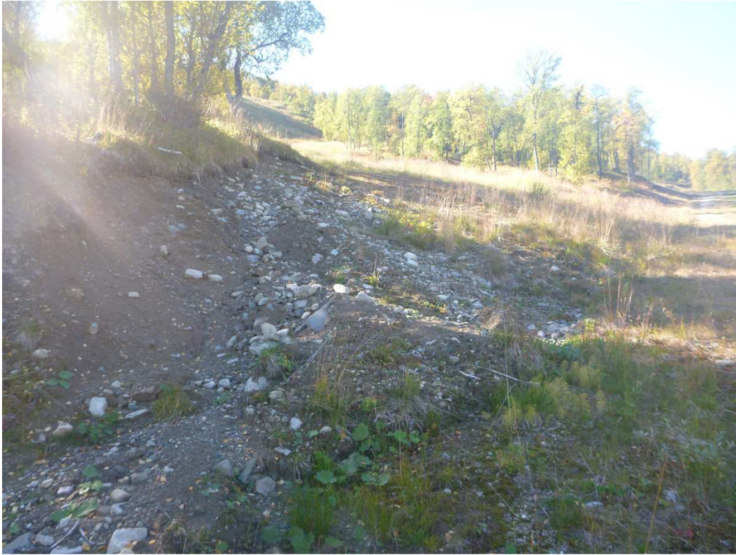
Ramundberget - karteringspunkt 1. Ytligt ras i schaktad slänt.
