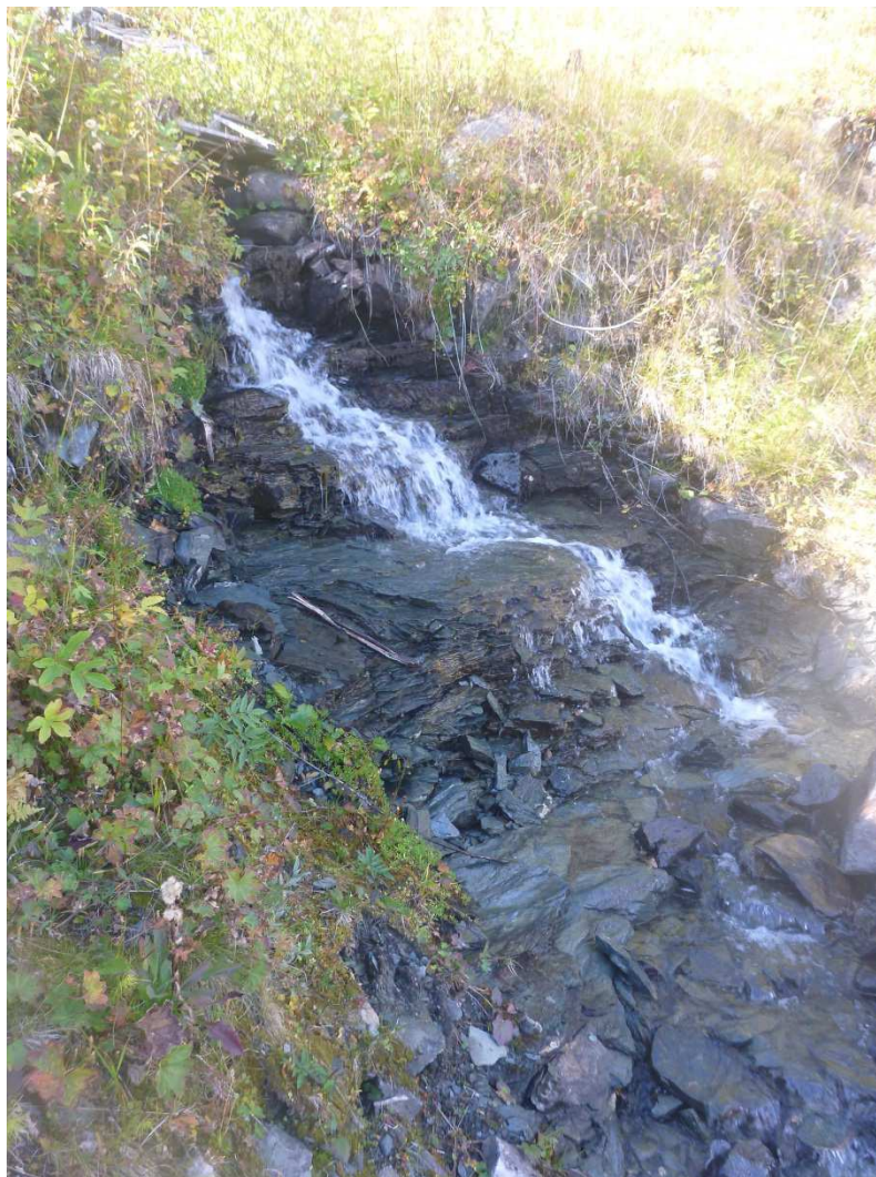
Ramundberget - karteringspunkt 8. Erosion i bäck uppströms kulvertering.
