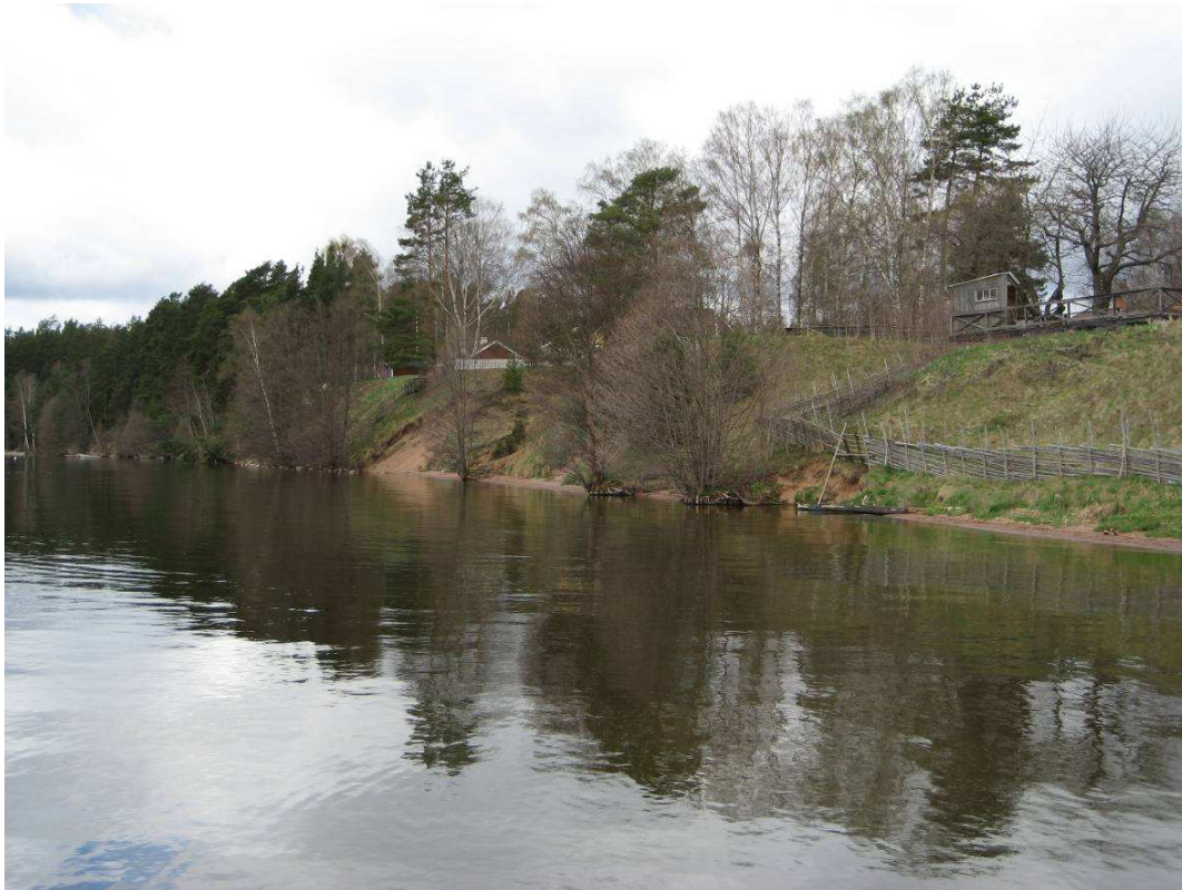
Figur 4-1. Exempel på erosions-skador utmed sjöstrand med isälvssediment. Foto: SGI.
