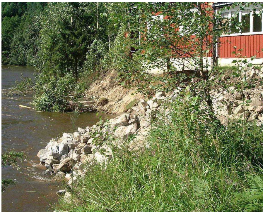
Figur 7-2. Exempel på stranderosion vid vattendrag. Erosion vid Ljungan, Krokforsen. Foto: SGI
