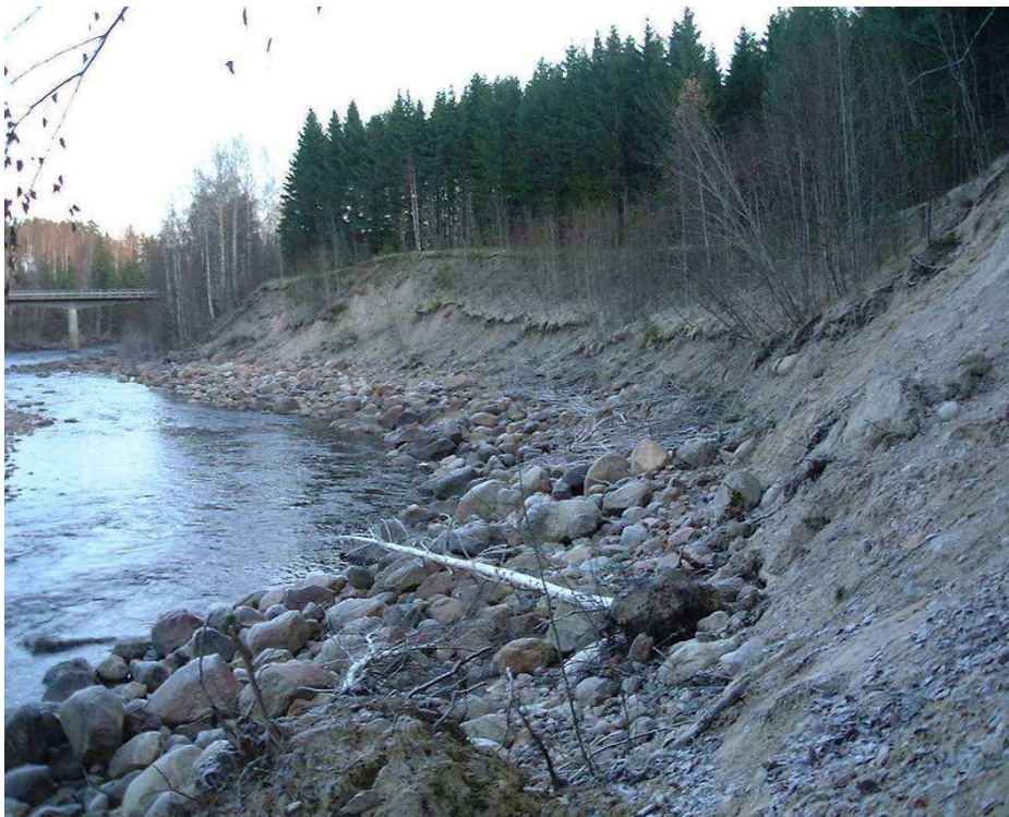
Figur 8-2. Skred och ras vid Voxnan i Bollnäs. Foto: SGI.
