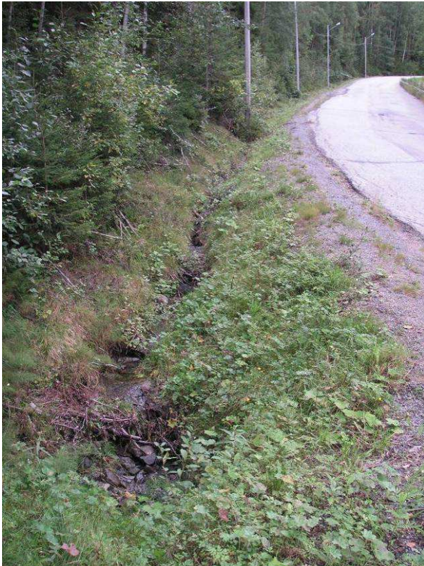
Bild 3. Fotograferat i punkt 3, södra sidan av vägen och i västlig riktning, inloppet till vägtrumma.
