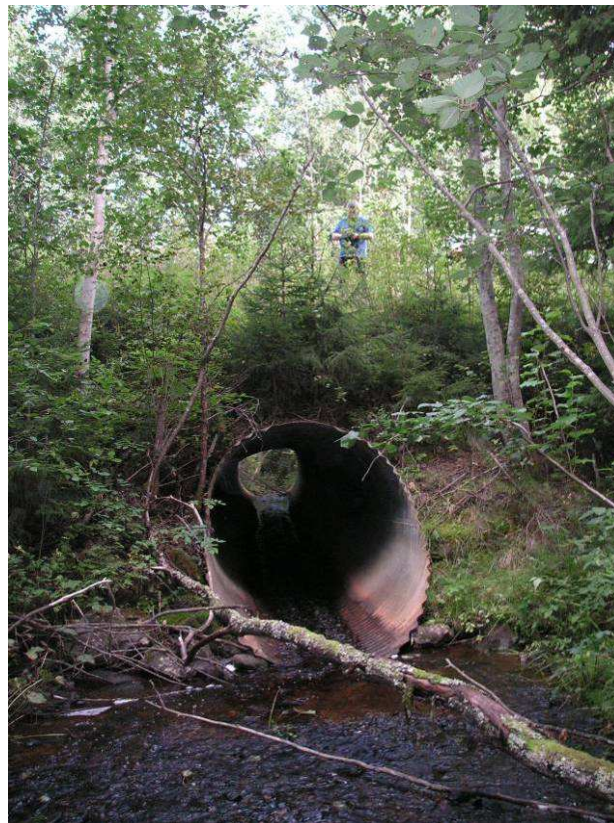
Bild 6. Fotograferat från punkt 4 i östlig riktning. Relativt stor bäck som passerar en mindre väg, inloppet till vägtrumman.
