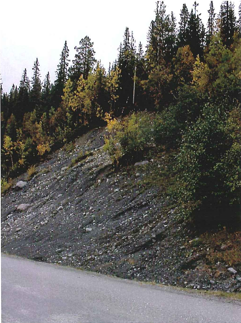
Bild 8:1 Intill Fjällhalsen, erosion i vägskärning
