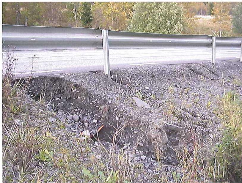
Bild 3:5 Undersåker, väg E14, erosionsskador i vägbank, vid karteringspunkt 1 Ristafallen (disk 3 bild 6)
