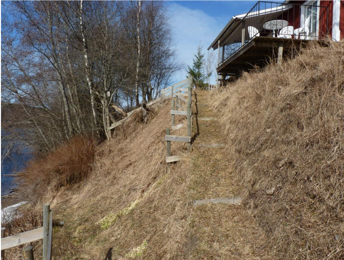
Foto 4: Vy från söder mot norr, bilden är från slänten nedan huset som är närmast skredärret, kanten på skredet är ca 60 m norrut. Foto: Räddningstjänsten i Torsby.
