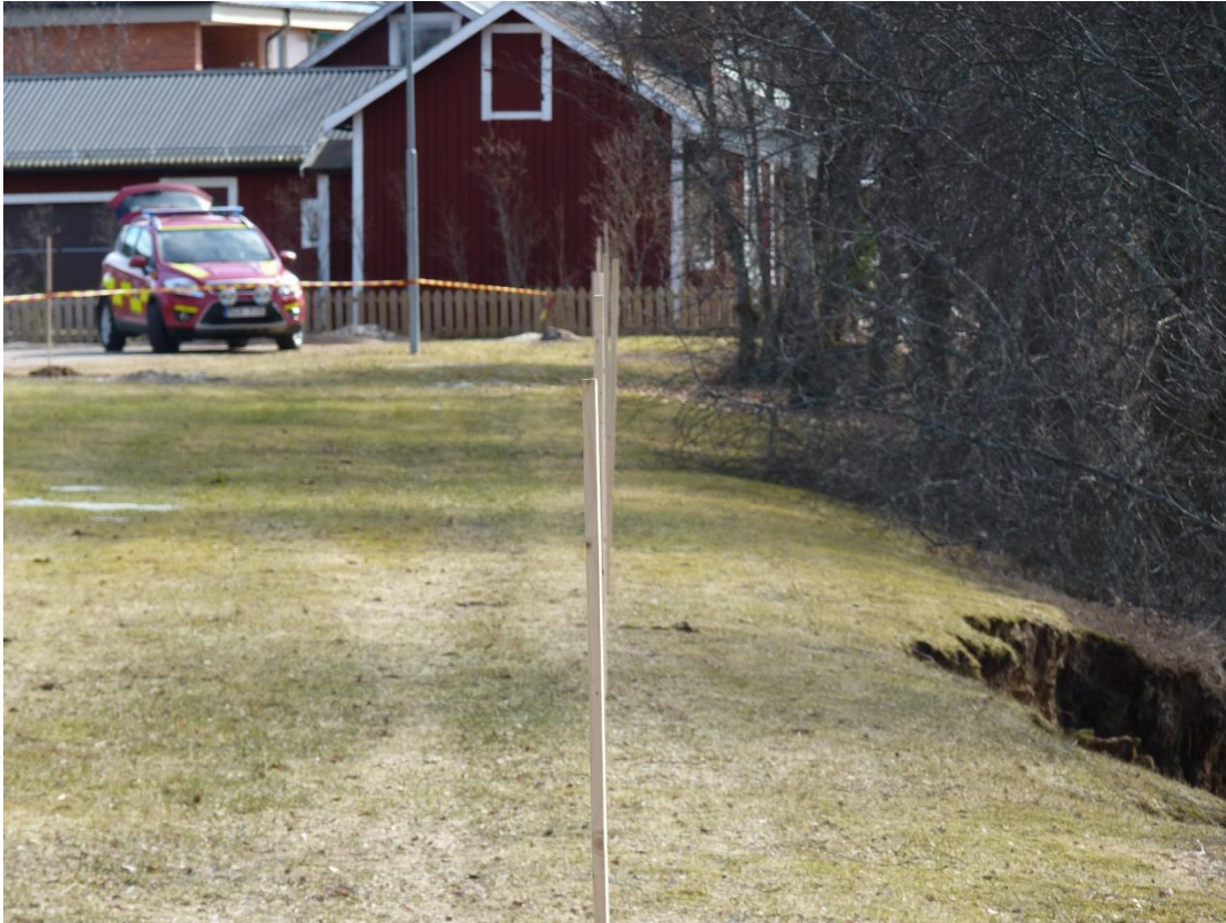
Foto 6: Vy från norr mot söder, bilden visar syftningslinjer i form av stakkäppar placerade någon meter bakom nuvarande skredkant. Foto: Räddningstjänsten i Torsby.
