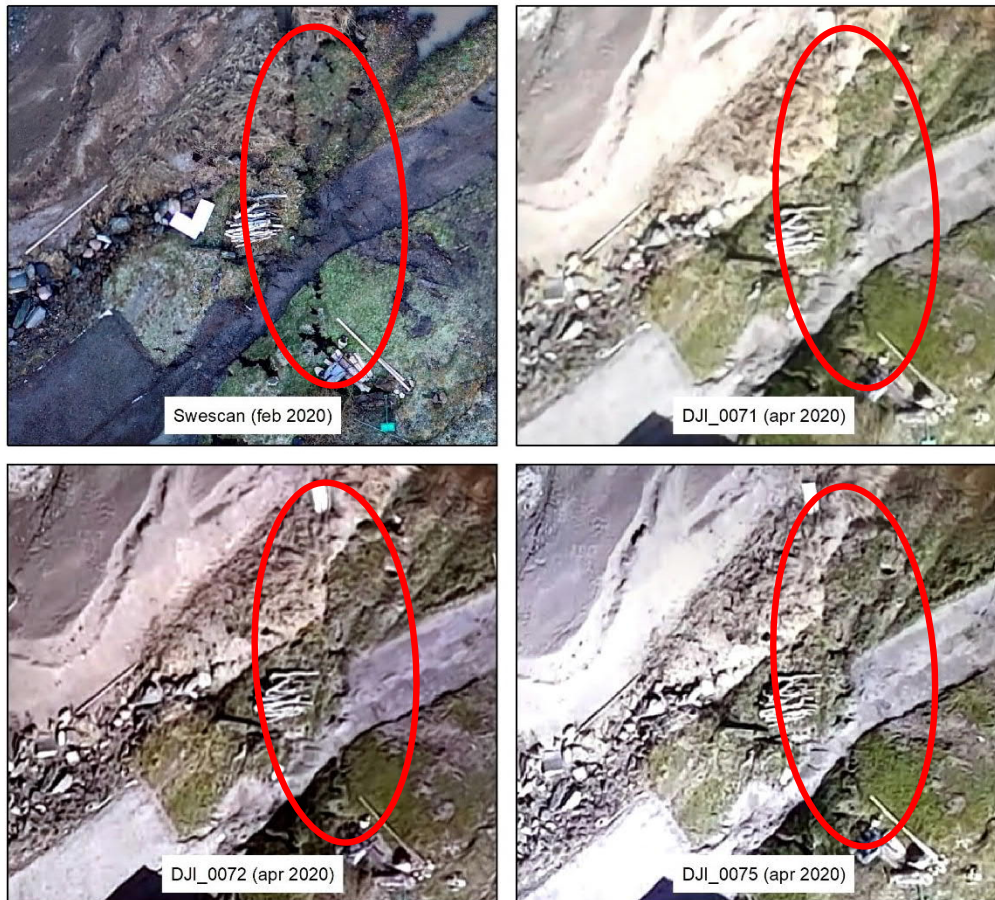
Figur 7 Exempel på visuella detaljer i bildmosaikerna från tre av testflygningarna. Trots skillnader i upplösning mellan den professionella flygningen (Swescan) och testflygningarna kan marksprickan i nord-sydlig riktning (inringad i rött) identifieras i samtliga mosaiker. Observera att flygningarna är gjorda vid olika tidpunkter, vilket förklarar varför vissa objekt från den övre vänstra bilden inte återfinns i de övriga. I bilderna ser man också tydligt att mosaikerna skiljer sig åt något i plan. Spridningstillstånd drönardata Dnr LM2020/003327 samt Dnr LM2020/017719.
